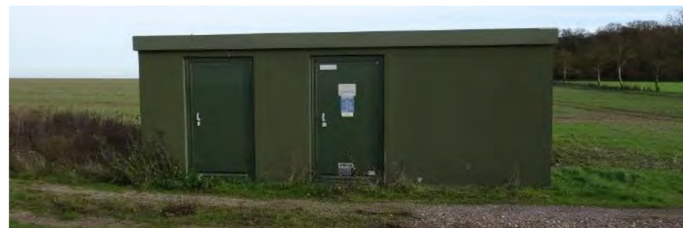
Photographie 64 : Exemple de poste de livraison avec peinture vert foncé (source : ABIÉS)
